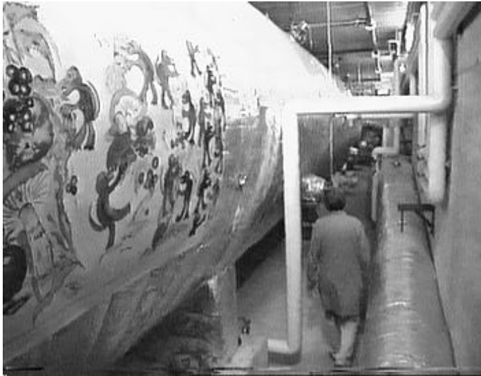
Ein Biogasreaktor besteht aus einem gasdichten Behälter (hier ein liegender Zylinder, der in einem Gebäude erstellt wurde), in welchen das Ausgangsmaterial über wärmeisolierte Rohre eingepresst wird.
